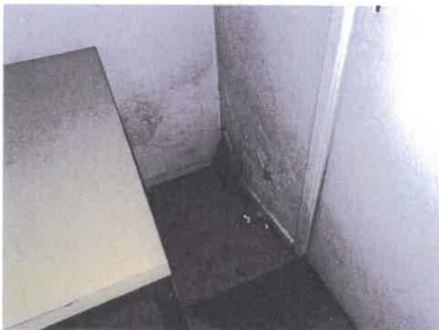
Kuva 5. Homekasvustoa ja kosteusvaurio kellarin nurkassa ja varauloskäynnin vieressä.
