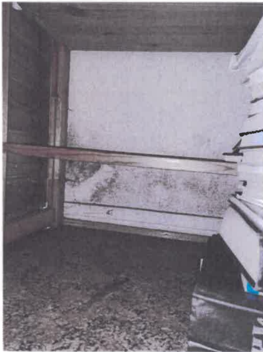
Kuva 3. Homekasvustoa ulkoseinän ja väliseinän liitoskohdan lähellä.
