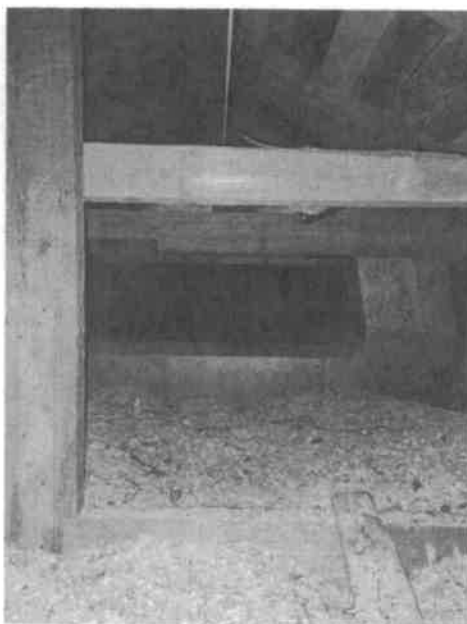
Kuva 8. Rukoussalin poistoilmakanava ullakolla.
