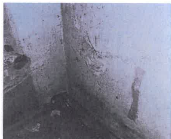
Kuva 6. Homekasvustoa ja kosteusvaurio kattilahuoneen nurkassa piipun alla.
